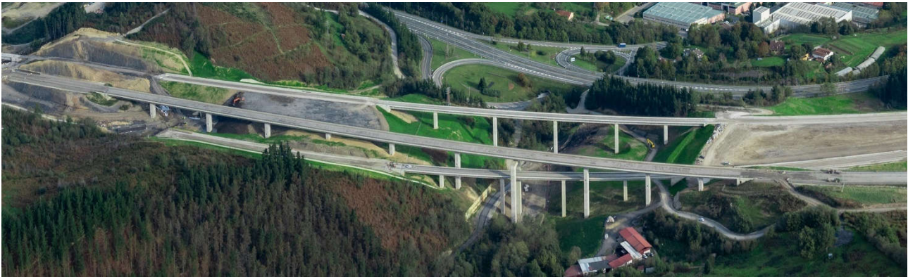
Figura 11. Vista general del cruce (salto de carnero) entre el ramal sur de la plataforma Bilbao – San Sebastián y el Viaducto sobre los arroyos de Zabaleta y Larrazábal, tras la finalización de las obras en los correspondientes tramos.
