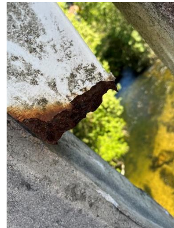
Figura 3. Oxidación en péndola.
