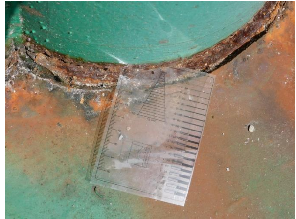
Figura 3. Soldadura péndola rota.
