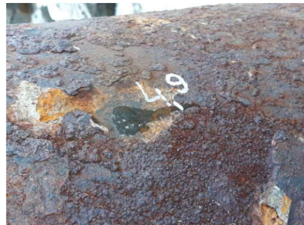
Figura 21. Corrosión en pilotes
